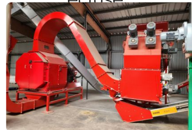
Démêleur, broyeur, filtre à écluse
