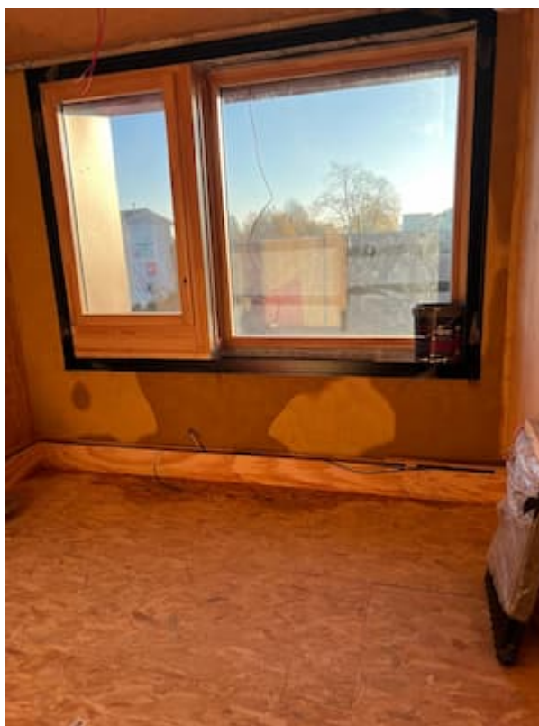
Exemple de sinistre dû à la migration de l'eau dans les murs en paille, à Langon. © CBS-Lifteam
