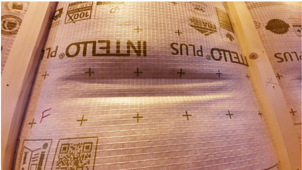
Photos 2 et 3 : Pare-vapeur après démontage des tasseaux horizontaux
